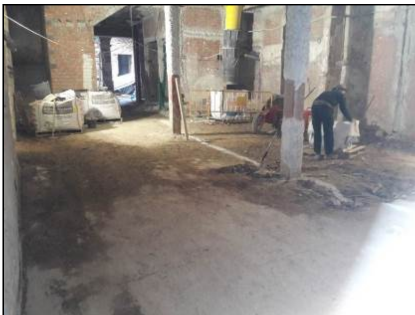
Fotografia 1. Vista general de l'àrea afectada.
